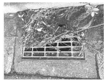
グレーチング上のゴミ詰まり
